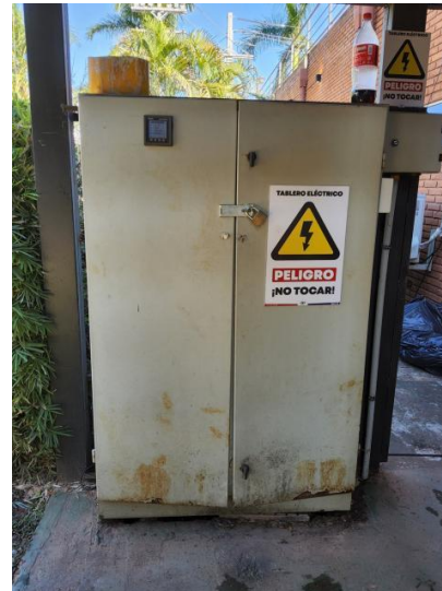
Corrosión en base y puertas.
