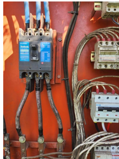
Protecciones y conductores deteriorados.
