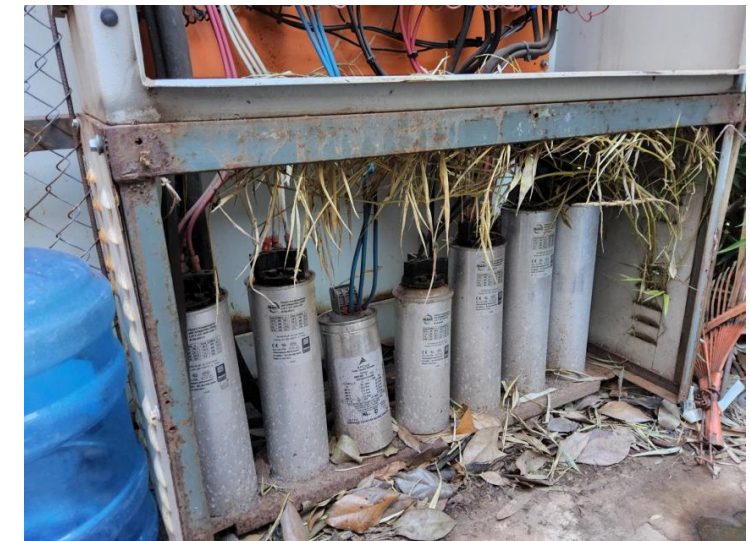
Vegetación y residuos en el interior.
