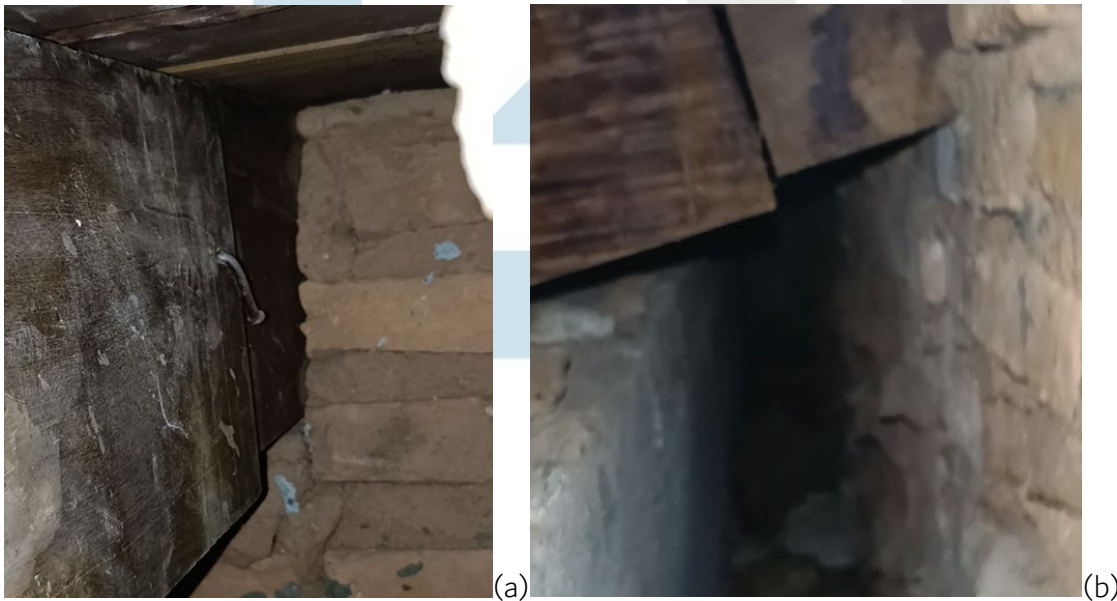
Fotografía 17. (a) Vista del tirante (b) Espacio entre mampostería detectada
